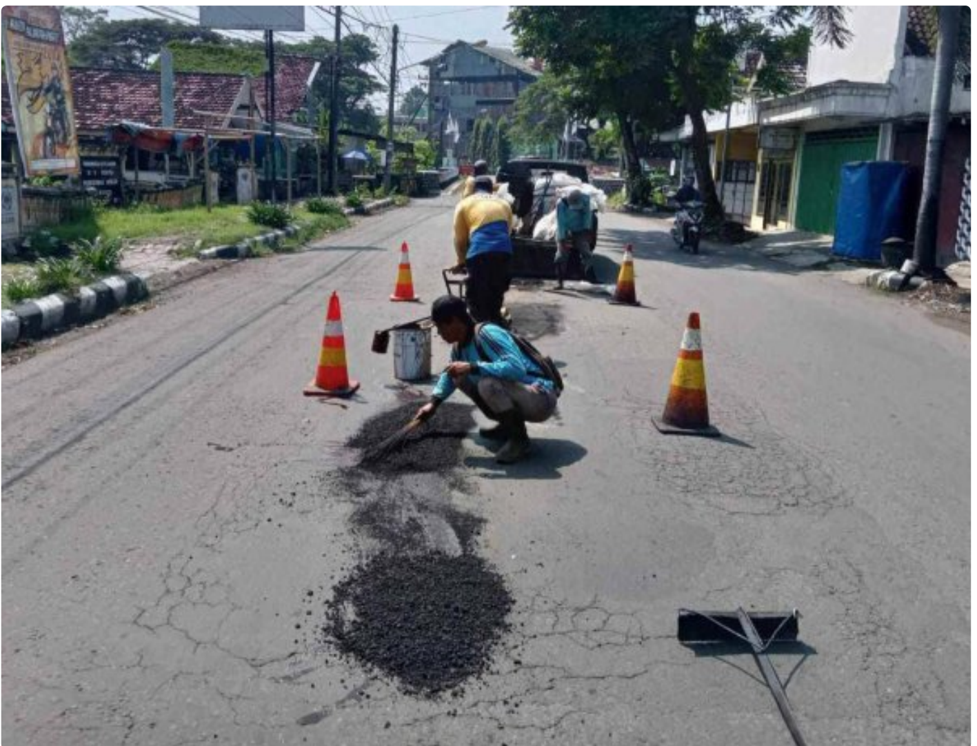
Dinas PUPR Kota Kediri menambal jalan berlubang di sepanjang Jalan Merbabu Mrican
